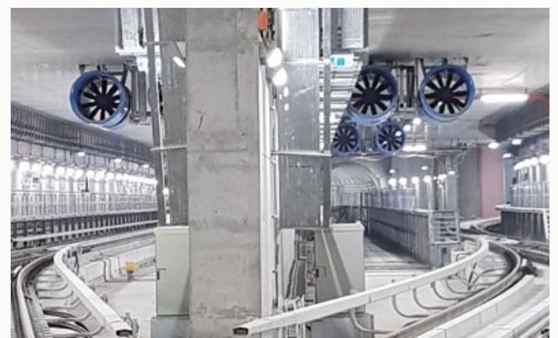
Système de ventilation de tunnel pour Metro Doha
