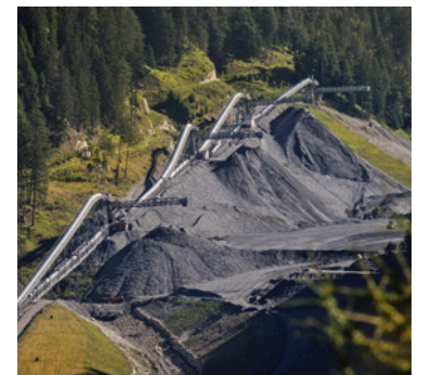
Installation de convoyeurs au tunnel de base du Brenner (décharge de Padastertal)
